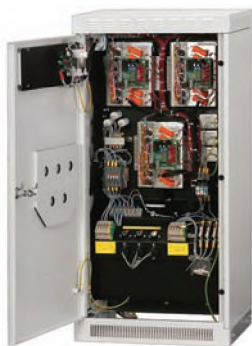
Oberon E12000-15 LC (внутреннее устройство)
