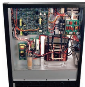
Изолирующий трансформатор, аккумуляторные батареи снизу в лотке
