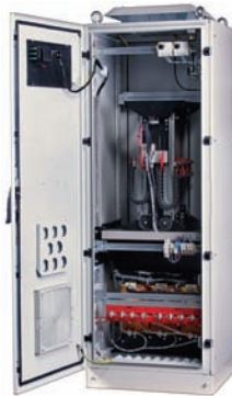
Стабилизатор Oberon M - IP54 (25-160 кВА) внутренняя компоновка
