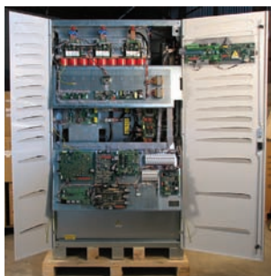
N-Power Evo 200 кВА внутреннее устройство
